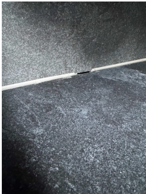
Sluss for synliggjøring av lekkasjevann toalett
