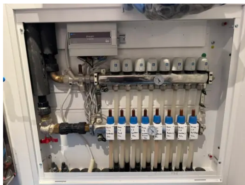
Fordelerskap vaskerom gulvarme
