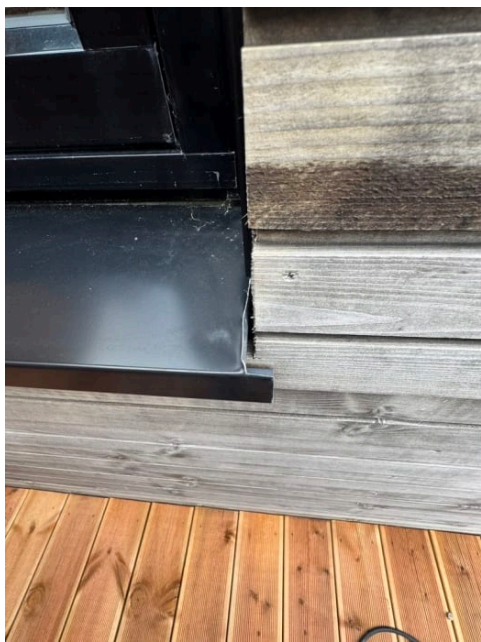
Vannbrett under vindu, avvik. TG 2
