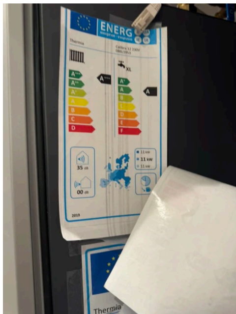
Vannbåren varme kjele
