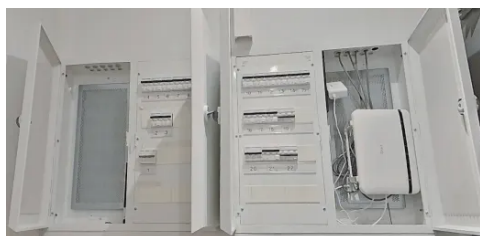
El-skap teknisk rom
