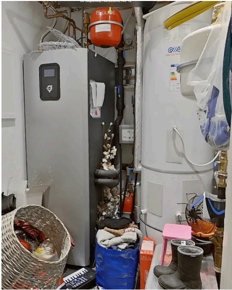
Bilde fra teknisk rom
