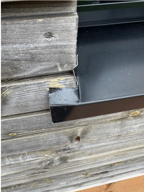
vannbrett med avvik
