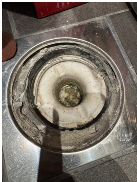
Sluk teknisk rom
