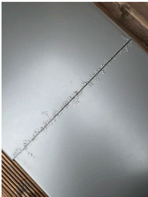
Alutile fasadeplater gjennomgående korrodert i kanter over hele fasade.
