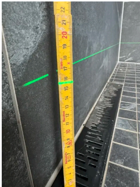
Måling fra topp slukrist i nedsenket dusjsone.
