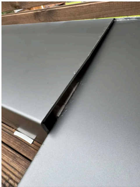
Topp yttervegg (Parapet) med knekte Alutile plater uten tett overgang/ skjøl.
