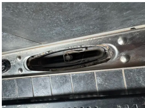
Sluk dusj 3 etasje. slisse sluk uten mulighet til å kontrollere membran.
